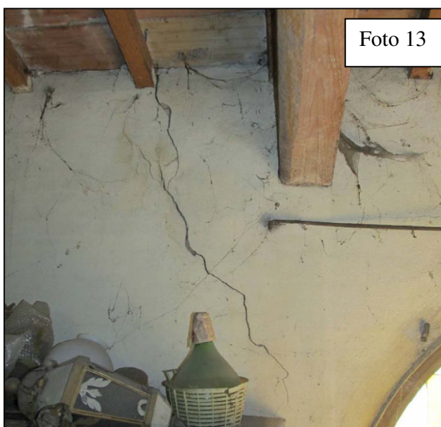
Foto 13: lesione nella muratura perimetrale del locale sagrestia posto sul lato destro della chiesa.
