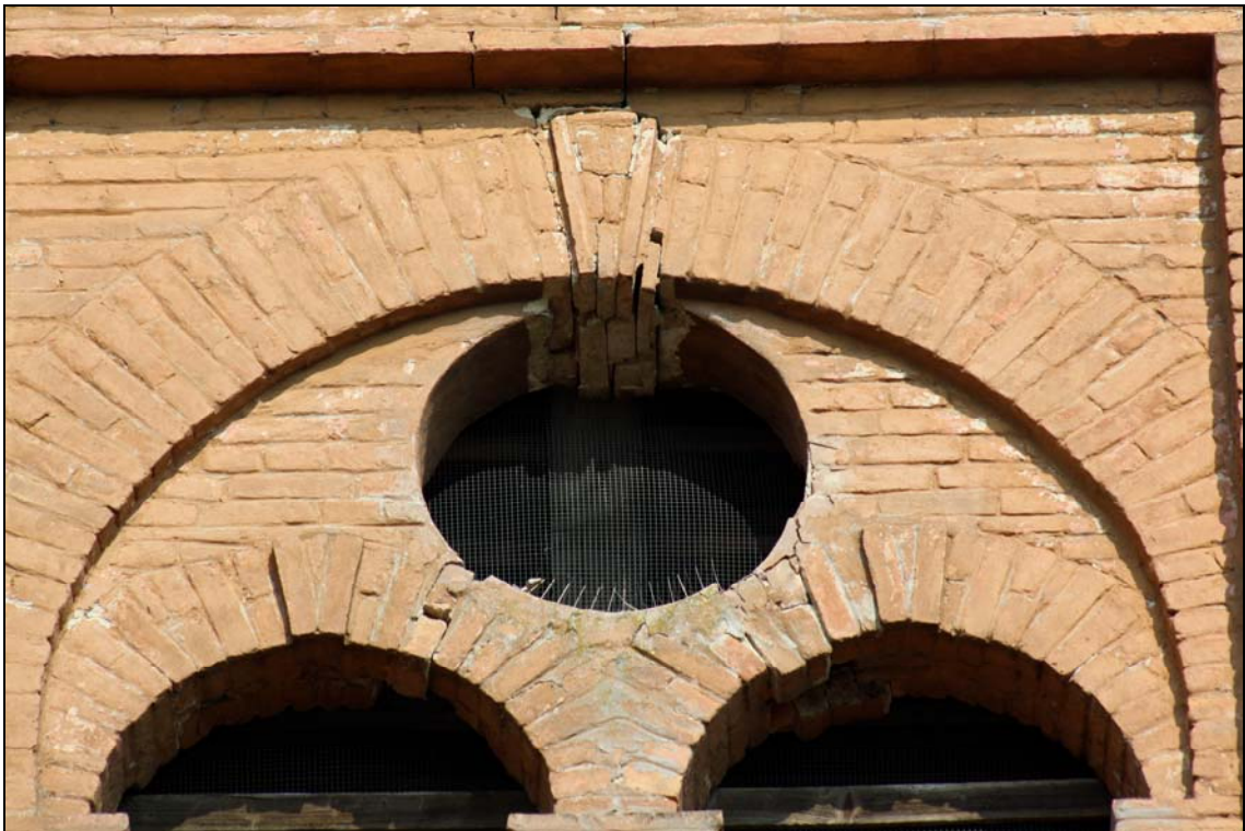
foto 12 – dettaglio di una delle bifore della cella campanaria: evidenti i segni di dissesto in corrispondenza degli archi
