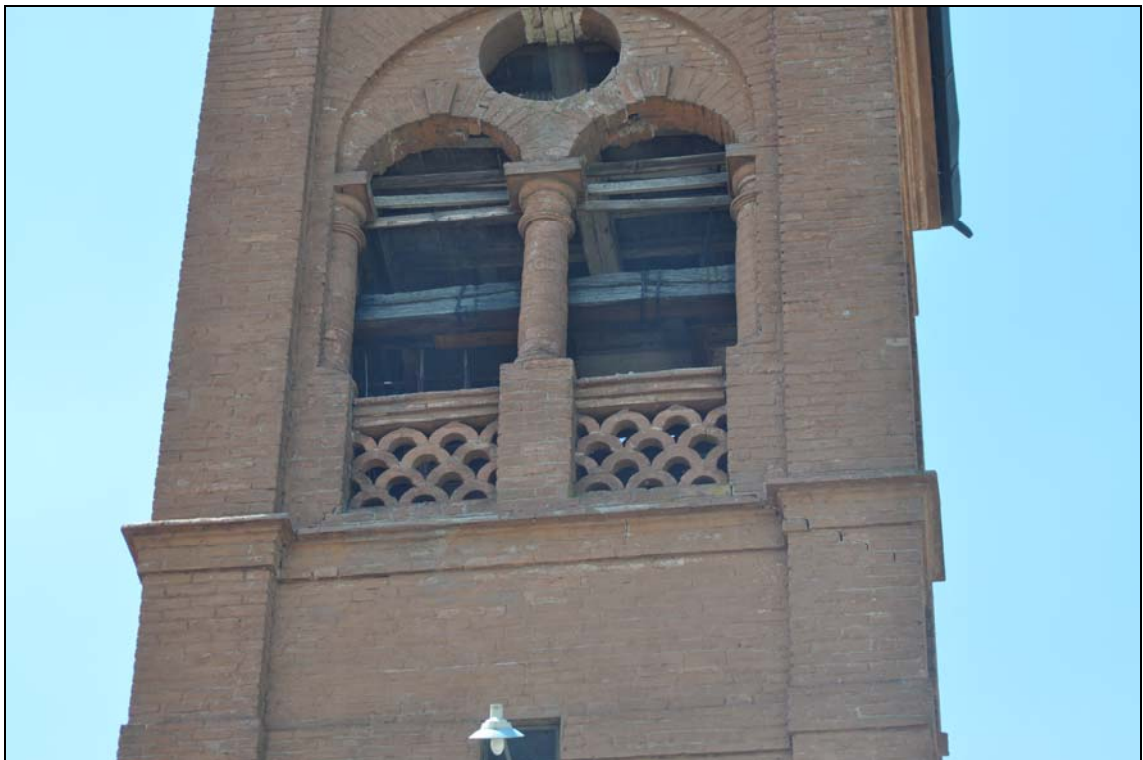
foto 10 – prospetto est; la cella campanaria caratterizzata da bifore traforate che le conferiscono notevole vulnerabilità
