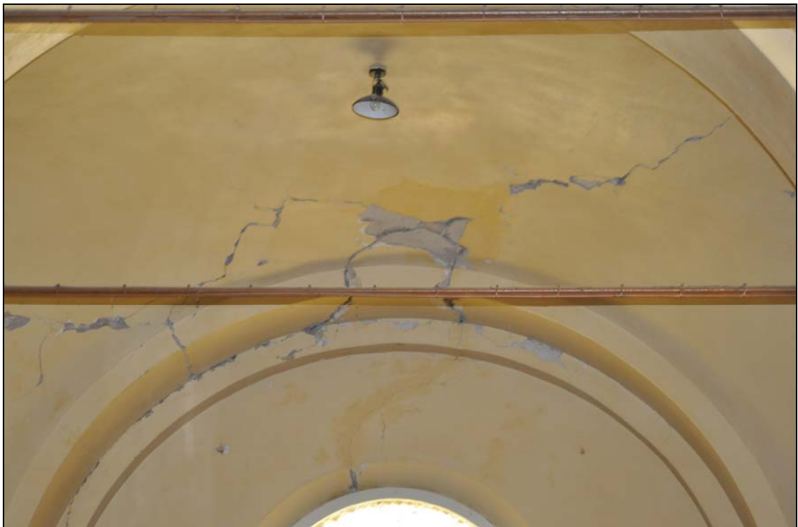
foto 6 – lato sinistro, prima cappella: evidenti le fessurazioni che interessano la volta a vela
