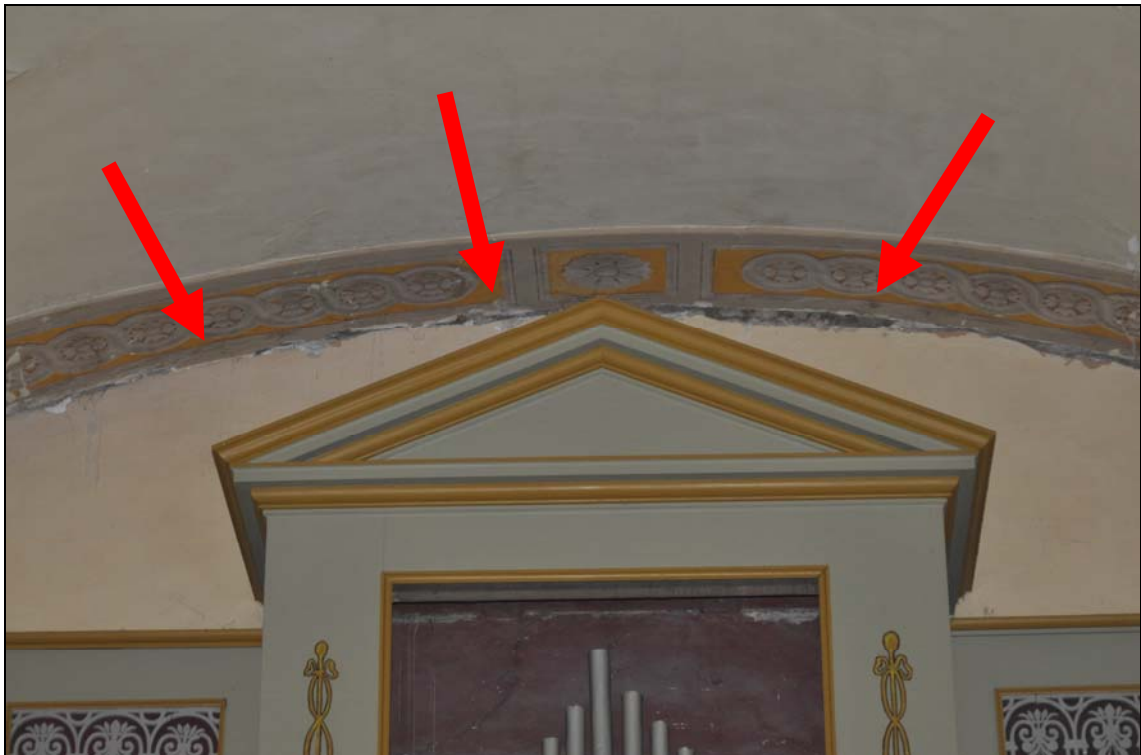
foto 2 – all'interno, sulla sommità della parete di controfacciata, si nota la fessurazione che percorre tutto il perimetro di attacco della volta in cannucciato alla parete
