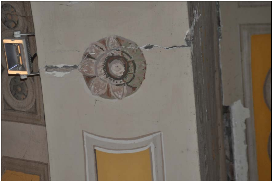
foto 9 – l'arco trionfale che separa la navata centrale dal presbiterio: in evidenza la lesione che attraversa la chiave dell'arco, vista dal basso
