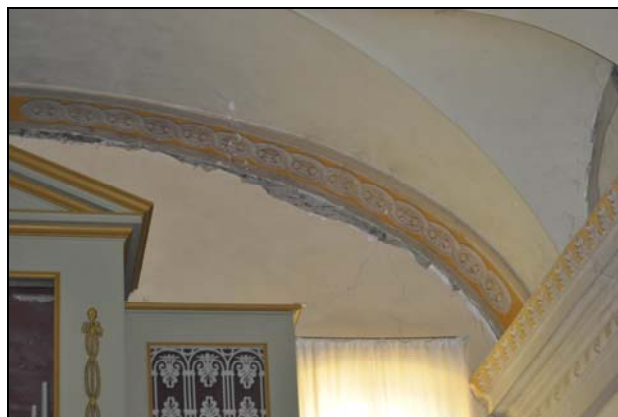
foto 14 - distacco sul perimetro di contatto tra la volta della navata in cannucciato e la parete di facciata
