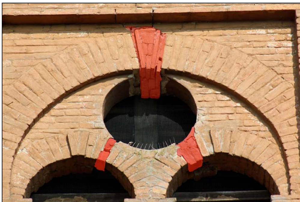
foto 13 – cella campanaria, lato ovest: in evidenza le lesioni in corrispondenza degli archi e della finestra circolare
