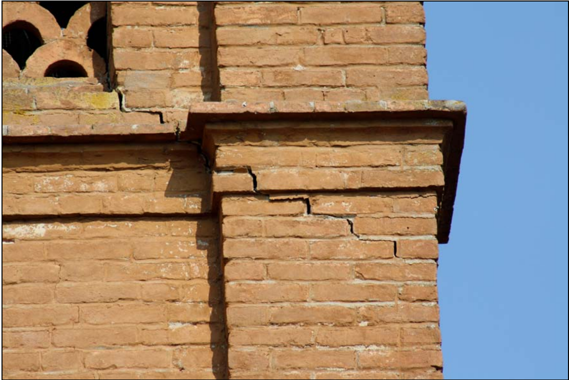
foto 11 – prospetto est; dettaglio di un cantonale della cella campanaria, lesionato in diagonale
