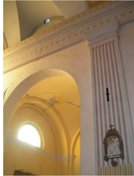
fotomontaggio con inserimento del paletto capochiave per l'ancoraggio delle nuove catene trasversali poste nelle navate laterali
