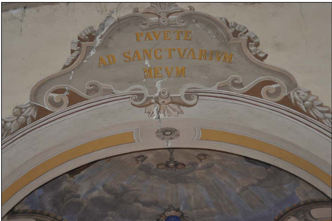
foto 8 – l'arco trionfale che separa la navata centrale dal presbiterio: in evidenza la lesione che attraversa la chiave dell'arco
