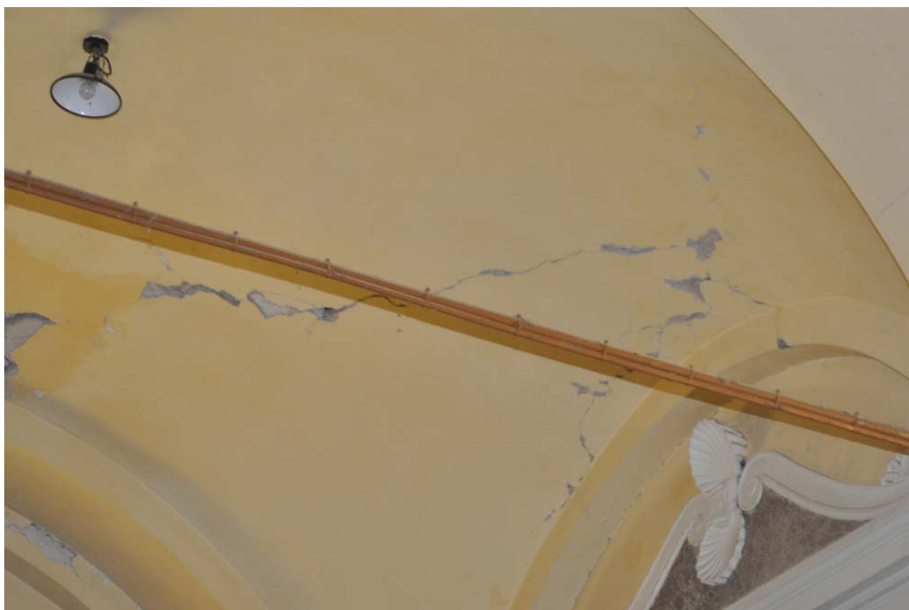
FOTO 22 - fessurazioni su volta della navata laterale destra
