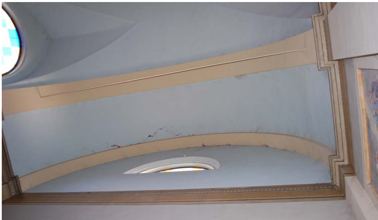
Prime lesioni a seguito del terremoto del 20.05.2012
