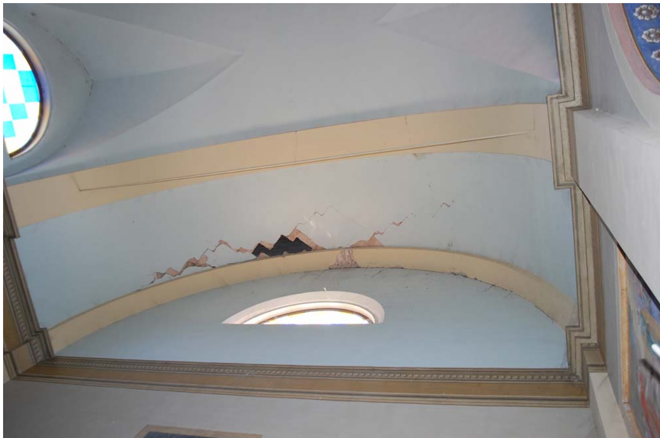
Immagini della volta dopo il terremoto del 29 maggio.
