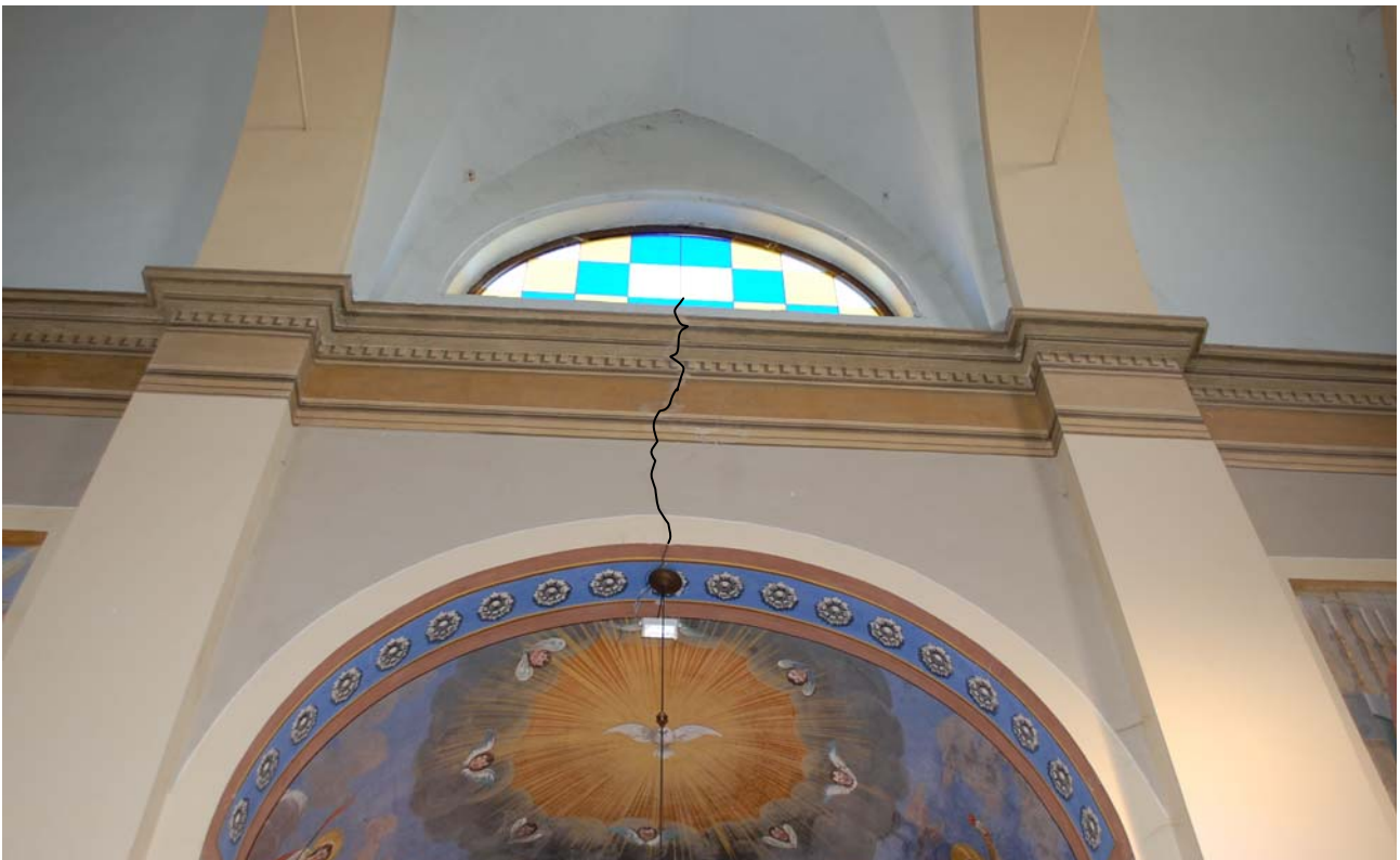
Dettaglio di lesione sull'arcata della cappella laterale dopo il terremoto del 20.05.2012
