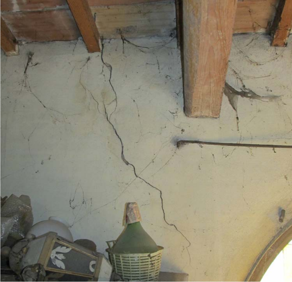
Lesioni anche nel tetto della sagrestia causate dal terremoto del 20.05.2012
