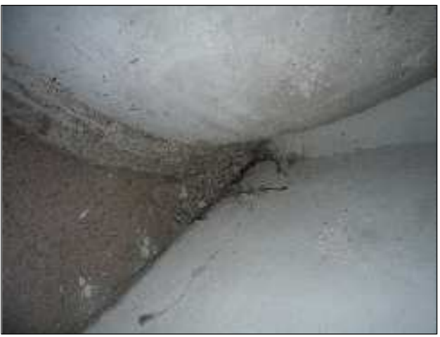
▲ 29 - Lesione orizzontale parete trasversale di corpo chiesa.
