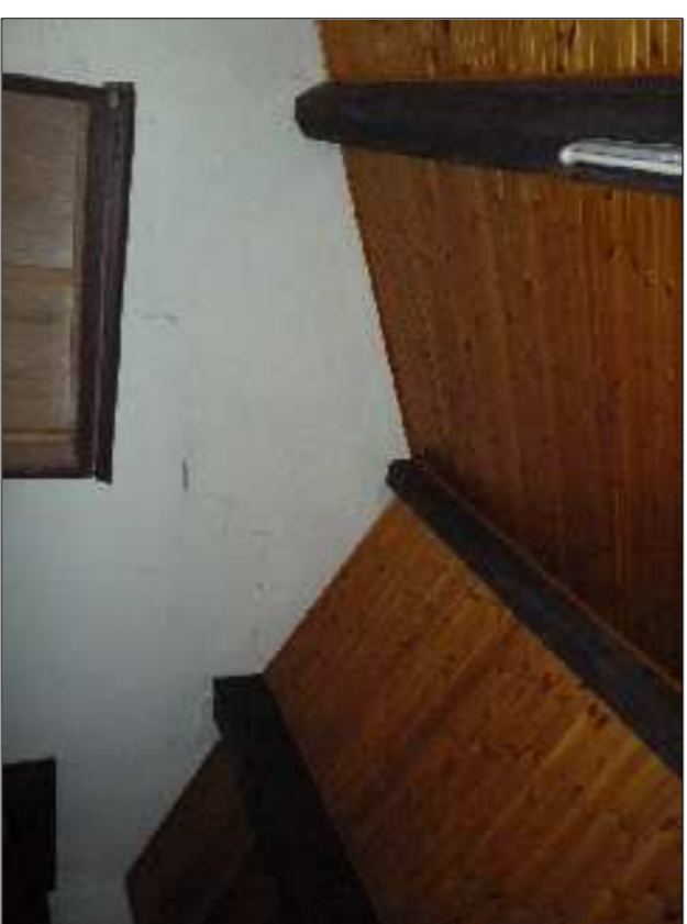
▲ 27 - Lesioni diffuse sulla parete in corrispondenza sfoltamento tetto (controllo esterni).
