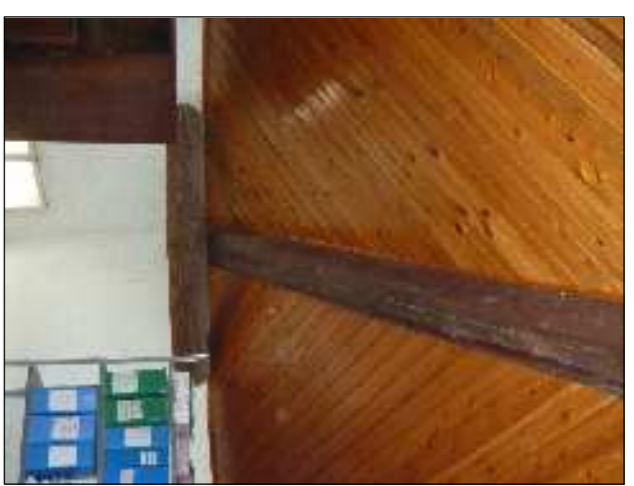
▲ 21 - Lesione in corrispondenza del contronole spingente.
