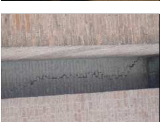
▲ 32 - Lesione di distacco della facciata. Lesione D
