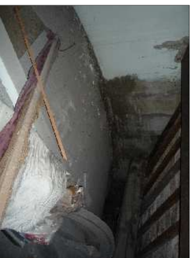
▲ 30 - Volta in laterizio distaccata.
