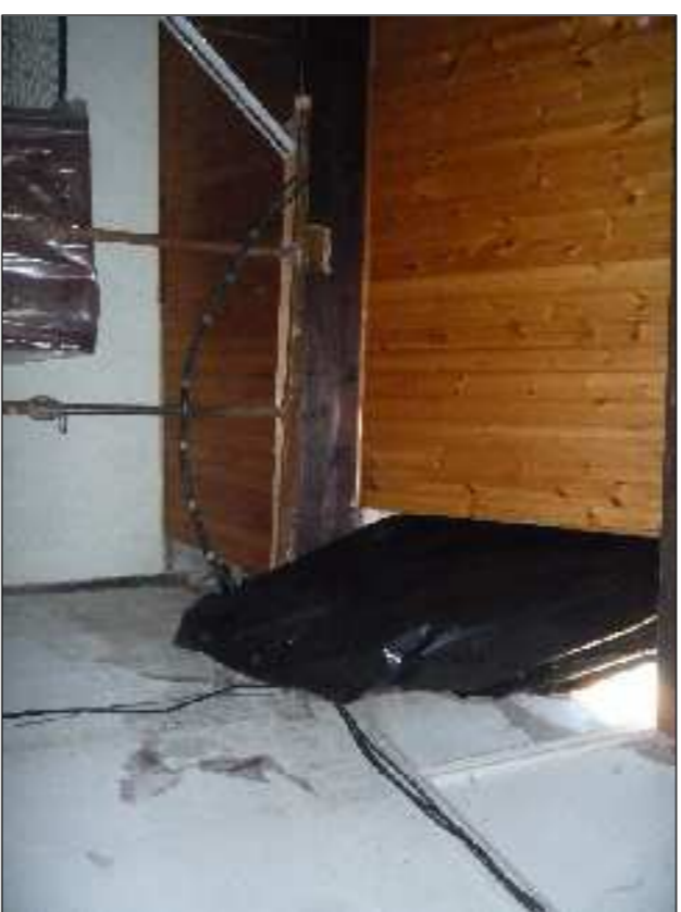
▲ 26 - Cedimento appoggio trave con crollo parziale copertura.
