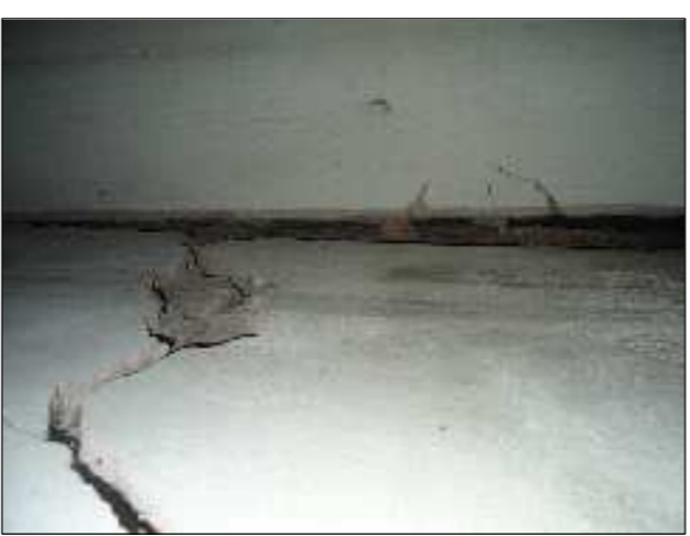
▲ 25 - Distacco parete trasversale in corrispondenza della chiesa.
