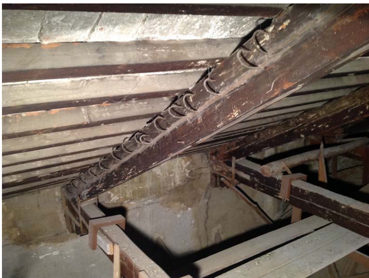
Foto 4 – Iniezioni e stuccature rigide. Tecnica oggi deprecata
